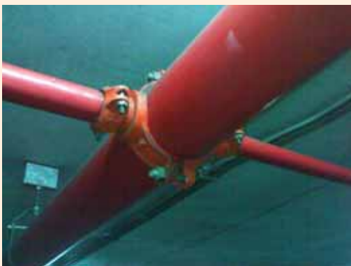
ตัวอย่างการติดตั้งแบบ Mechanical Cross ที่อาคารจอดรถ สนามบินสุวรรณภูมิ
